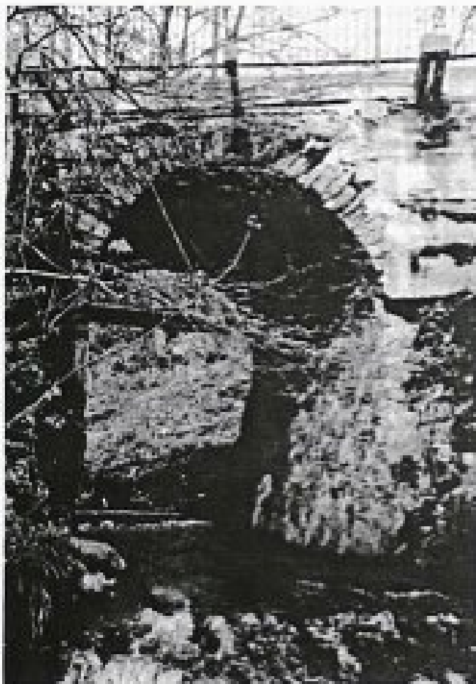
Most čez Konjščico v Rošpohu iz okoli leta 1785. Temelji so verjetno še rimski
